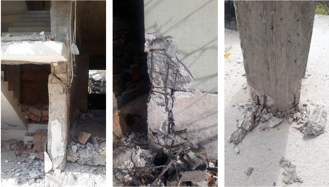
Şekil 1.6. Kolonlarda görülen hasar çeşitleri (Hatay, Antakya)
