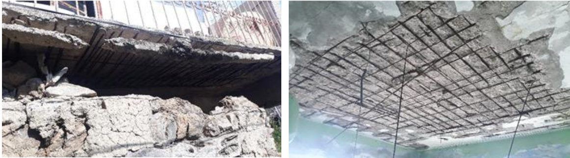
Şekil 1.7. Donatı korozyonuna örnekler (Hatay, Antakya)
