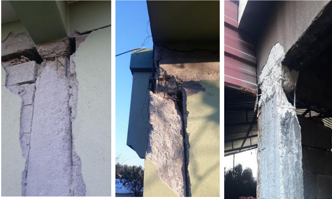
Şekil 1.4. Hasar tespit çalışmalarında kolon-kiriş birleşim bölgesinde görülen hasarlar (Hatay, Antakya)
