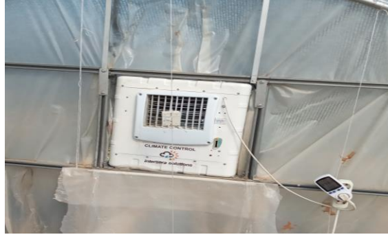
Şekil 3.6. Klimanın elektrik tüketim ölçümünden bir görünüm
