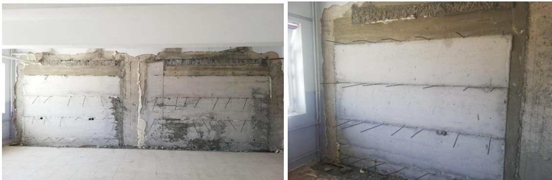
Şekil 4.118. Kalıpların sökülmesi ve beton dökülmesi esnasında oluşan üçgen fazlalık betonun kırılması
