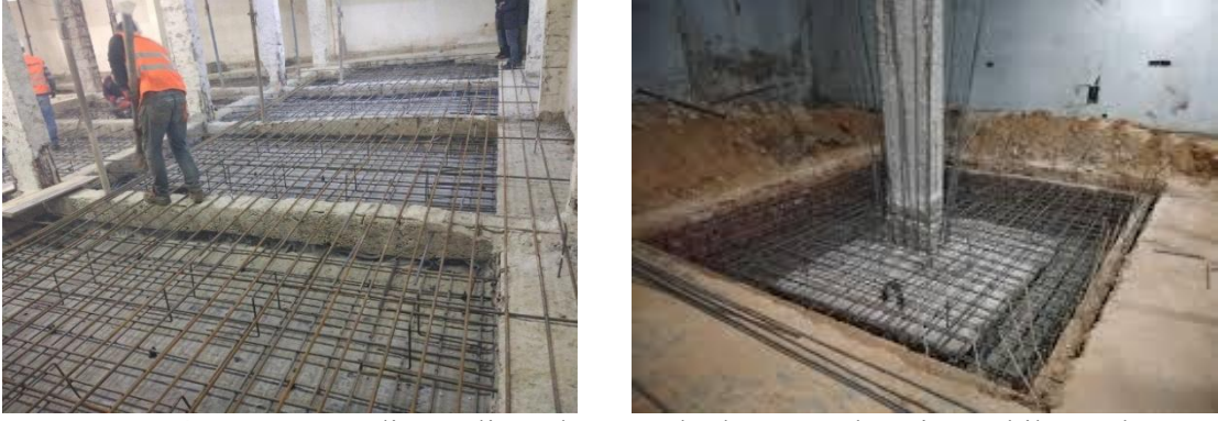
Şekil 4.92. Mütemadi temelin radye temeğe dönüştürülmesi ve tekil temel güçlendirilmesi
