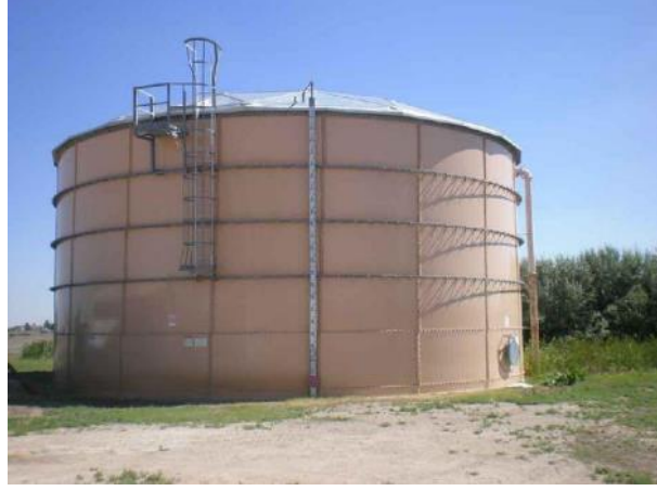
Şekil 3.15. Yer düzeyinde bulunan tank (CST, 2024)
