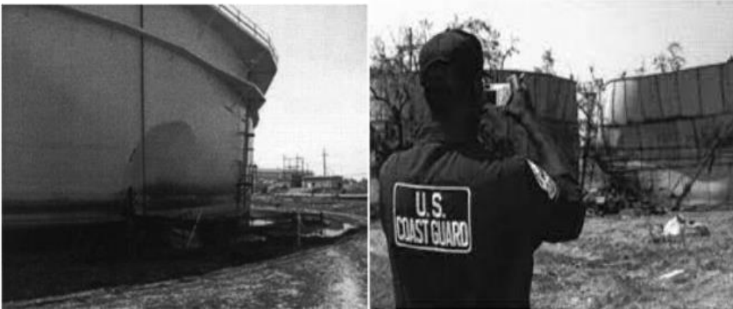
Şekil 3.9. Rita ve Katrina kasırgalarında tank göçmeleri (Godoy, 2007)
