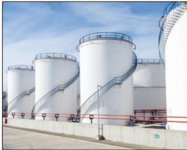
Şekil 3.2. Yer üstü sıvı depolama tank tesisi (Solvay, 2021)
