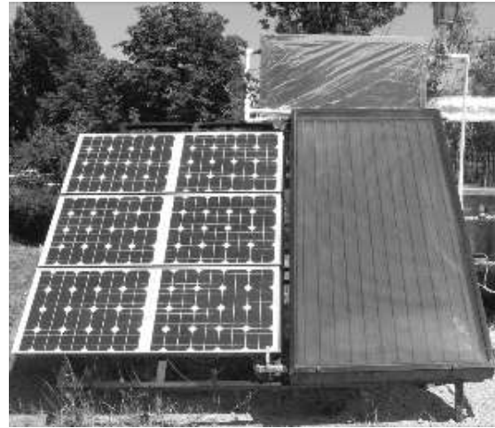
Şekil 2- Isı ve elektrik üreten güneř enerjisi sistemi Figure 2- Solar energy system that produces heat and electricity energy
