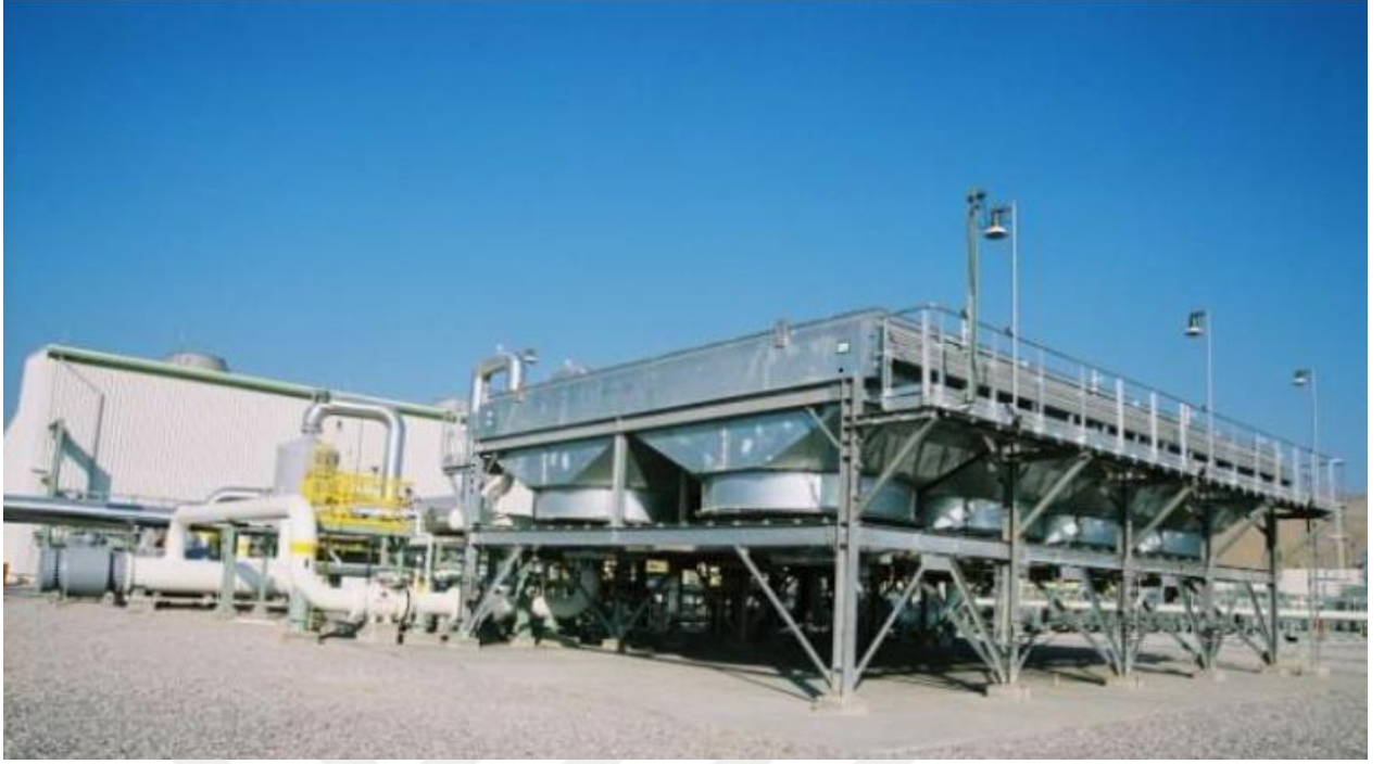
Şekil 2.17. Gaz Soğutma Ünitesi (TML, 2003)
