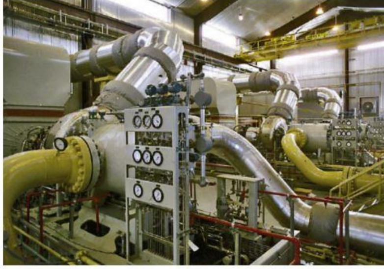
Şekil 2.10. Üç Adet Santrifüj Kompresör Ünitesi Bulunan Kompresör İstasyonu (Mokhatab, 2007)
