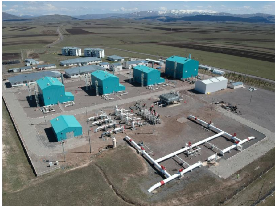
Şekil 2.8. Endüstriyel Bir Doğal Gaz Kompresör İstasyonu (Okay, 2019)
