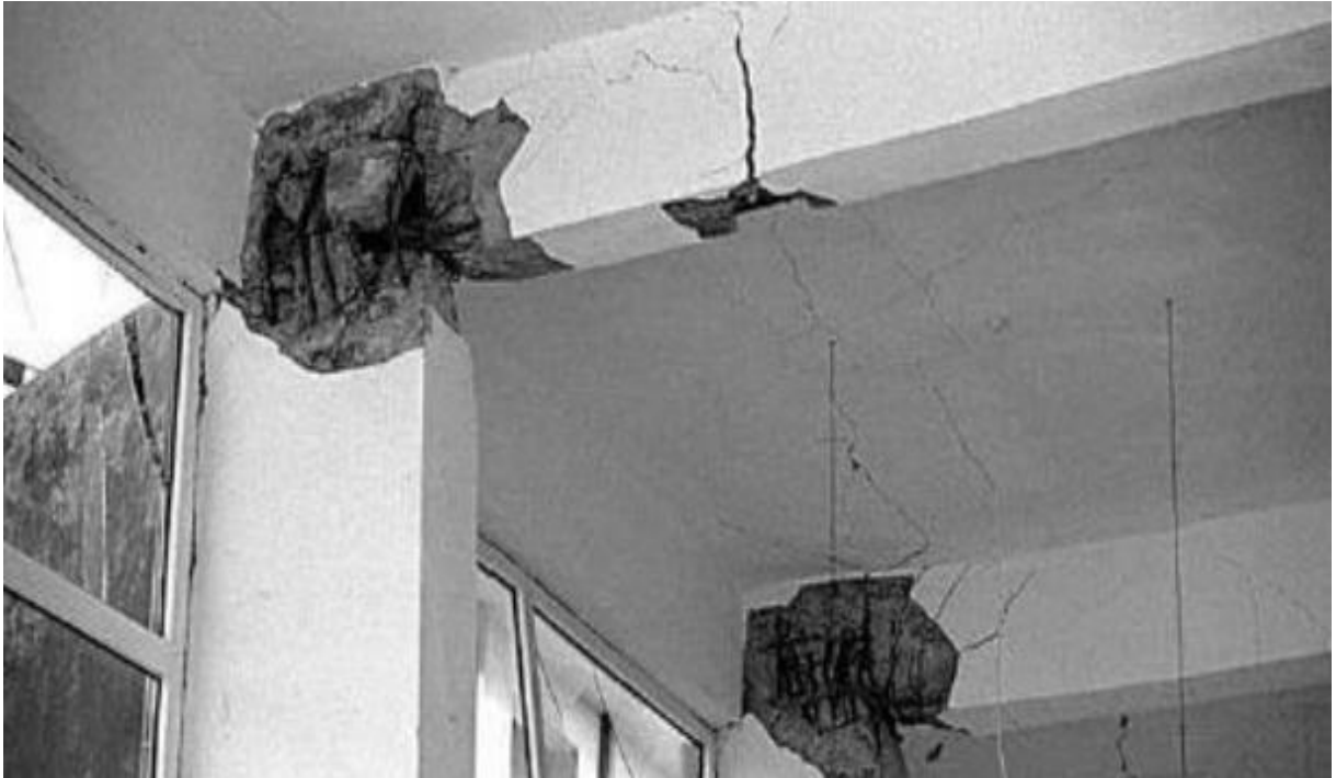
Şekil 3.3. Düğüm noktasında mafsallaşma ve kirişte eğilme çatlakları (Raofe, 2019)
