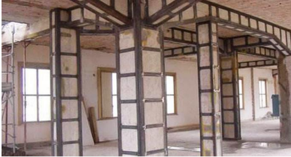
Şekil 4.10. Kirişlerin çelik levhalar ile sararak güçlendirilmesi (Urgancı, 2021)
