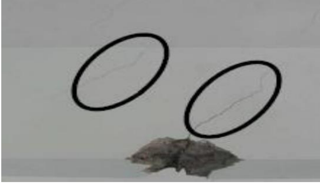
Şekil 3.4. Kirişte oluşan kesme çatlakları (Çırak, 2011)
