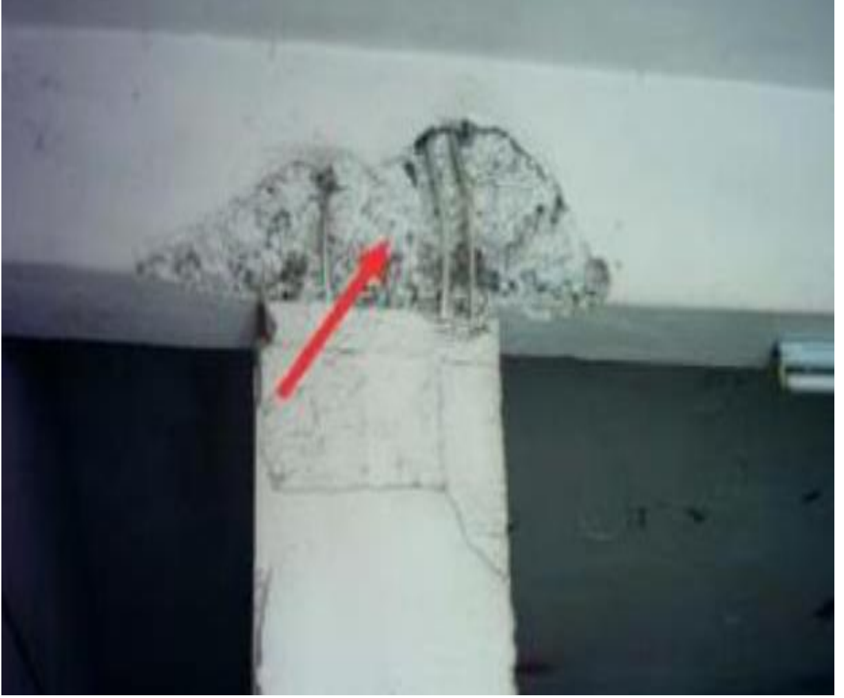
Şekil 3.9. Kolon-kiriş birleşim bölgesinde meydana gelen hasar (Koç, 2016)
