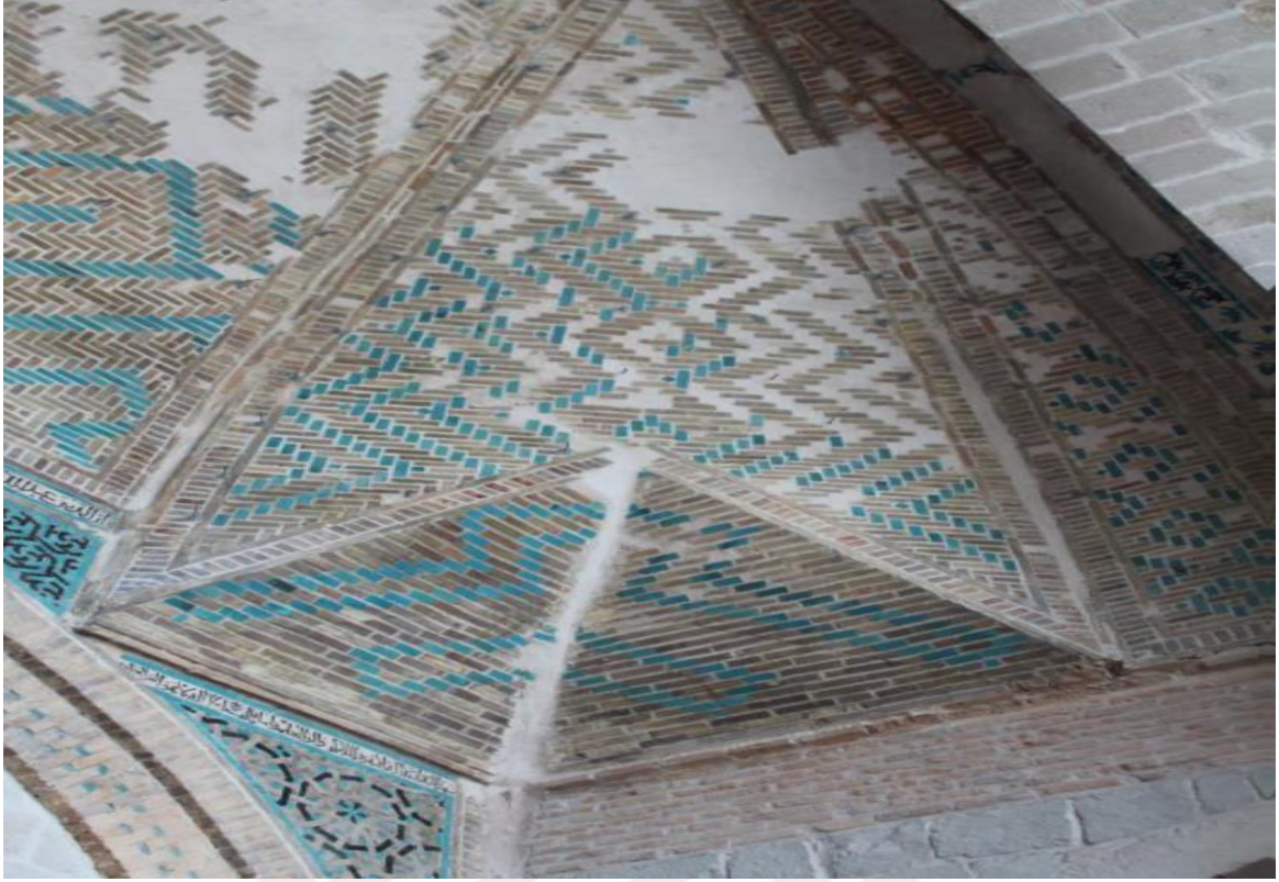
Şekil 2.29. Malatya Battalgazi Ulu Camii Eyvanı ve TonoZları Detayı (Aslı Ümran Ulaş Arşivi, Malatya Battalgazi 2023)
