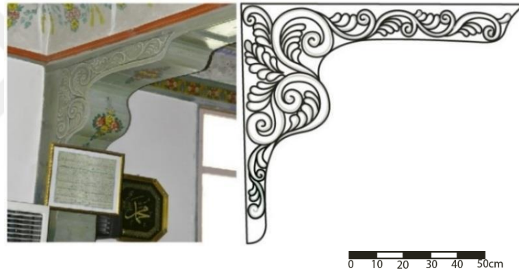
Şekil 4.110. Sol Sahın, Güneybatı Cephe Sütun Kemer Başlığı, Detay Görünümü ve Çizimi (Kaya, 2018)
